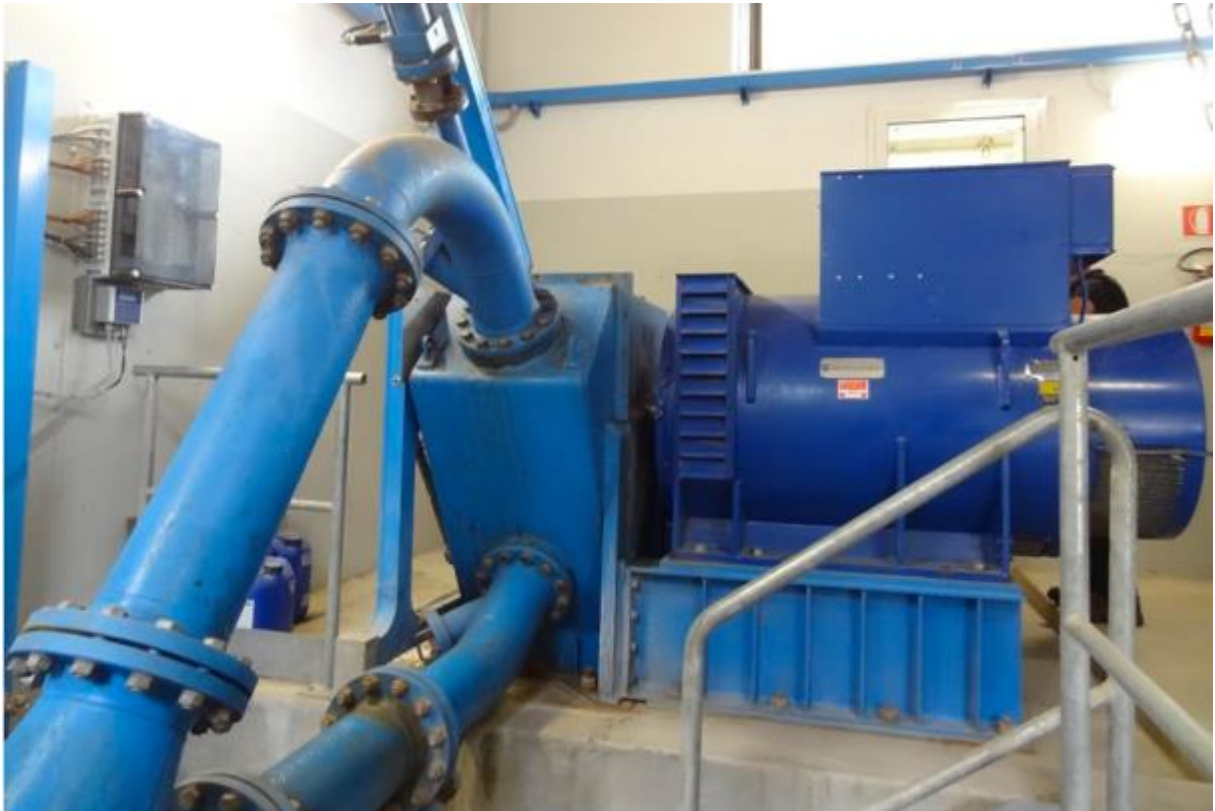
Pelton-Turbine des Kraftwerkes Vallesina
