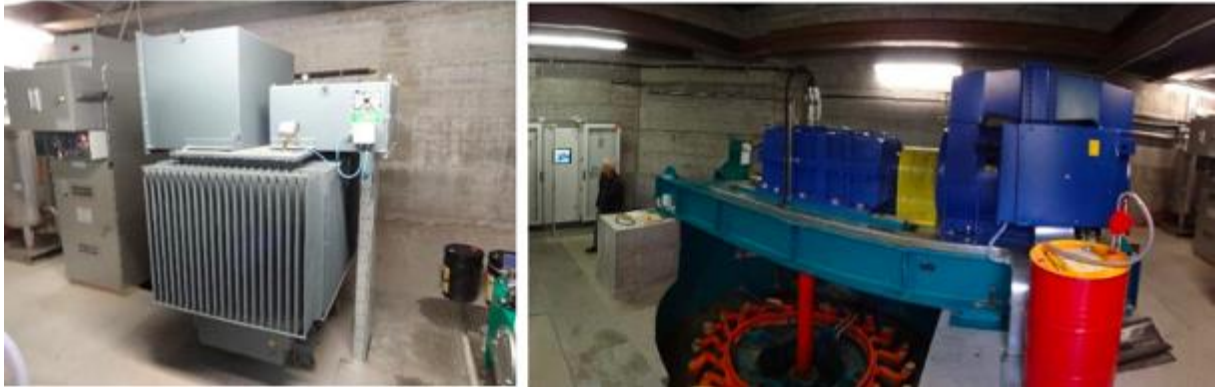
Wasserkraftwerk Villarfochiardo mit Kaplan -Turbine
