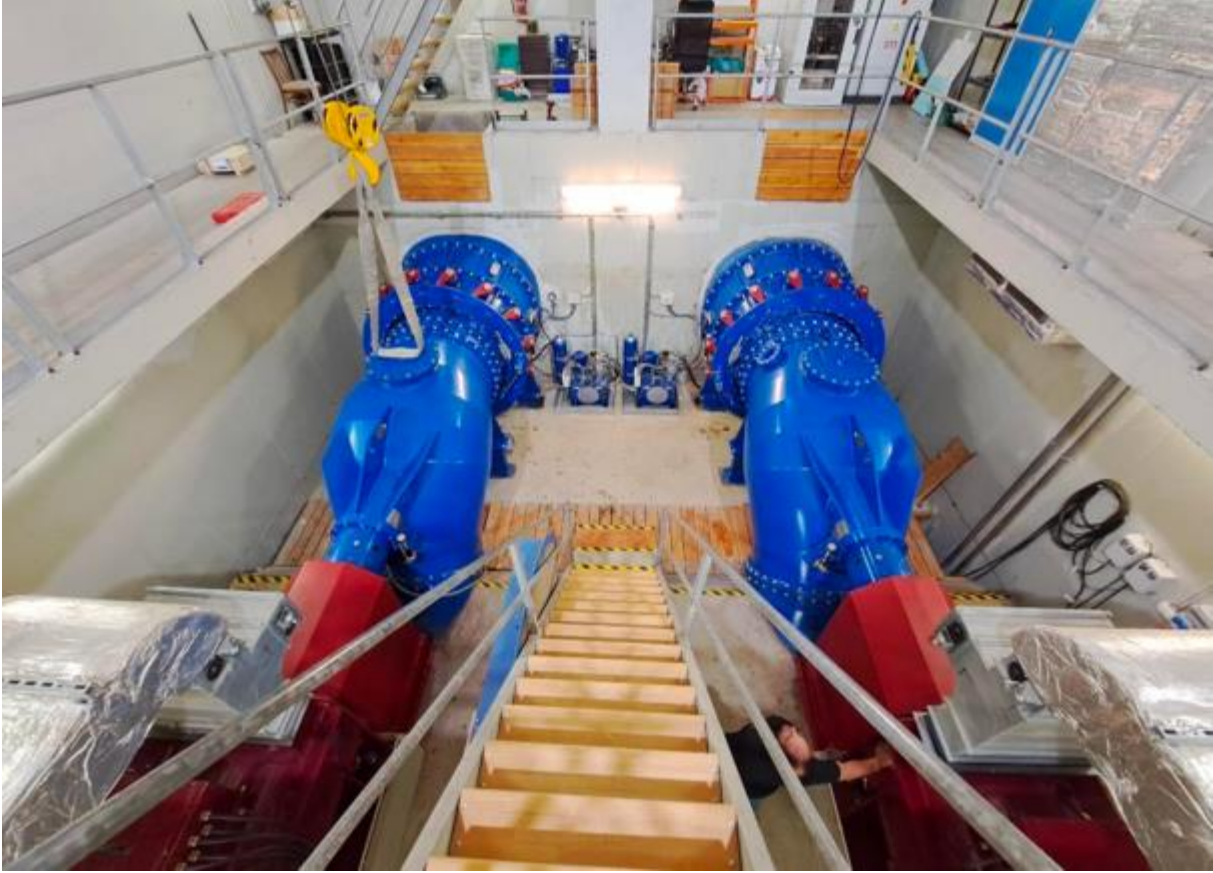
Kaplanturbinen der Wasserkraftanlage Sacurov
