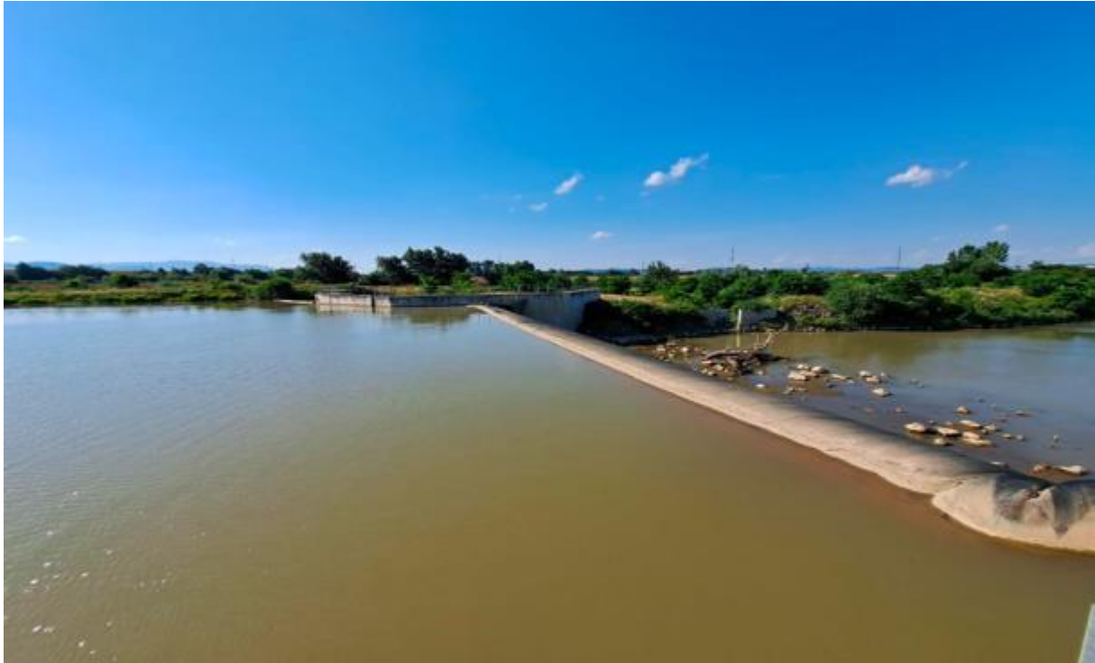
Modernes Schlauchwehr der Wasserkraftanlage Sacurov
